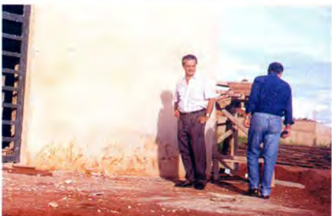
O Diretor Geral da Esmagis, Des. Rêmolo Letterieño, de frente, e o presidente da Amansul, juiz Ruy Celso Barbosa Florence, vistoriam a construção do auditório da Escola.
